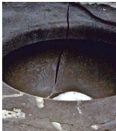
Abb. 1 Risse im Muldenrand
